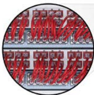
Parcheo Directo del Switch con Cables de parcheo de 8"
